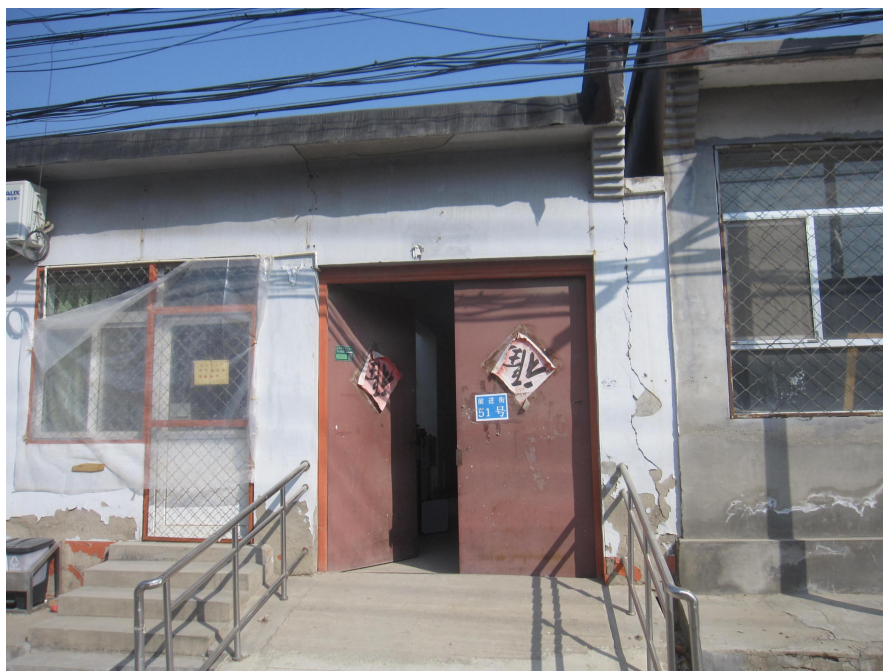
图 3-6 后渠河村房屋开裂（镜像北）
