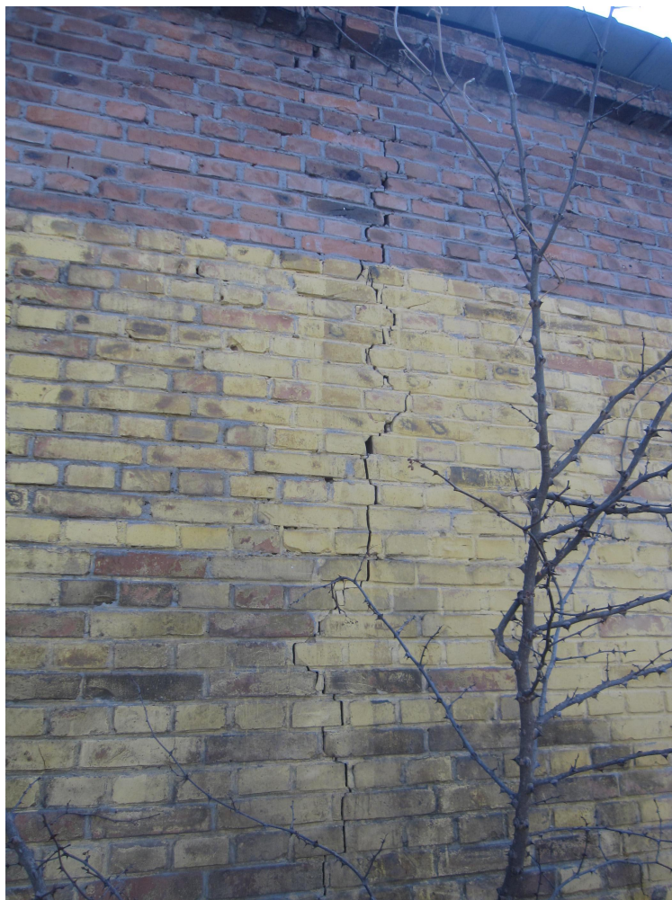
图 3-5 后渠河村房屋开裂（镜像东）
