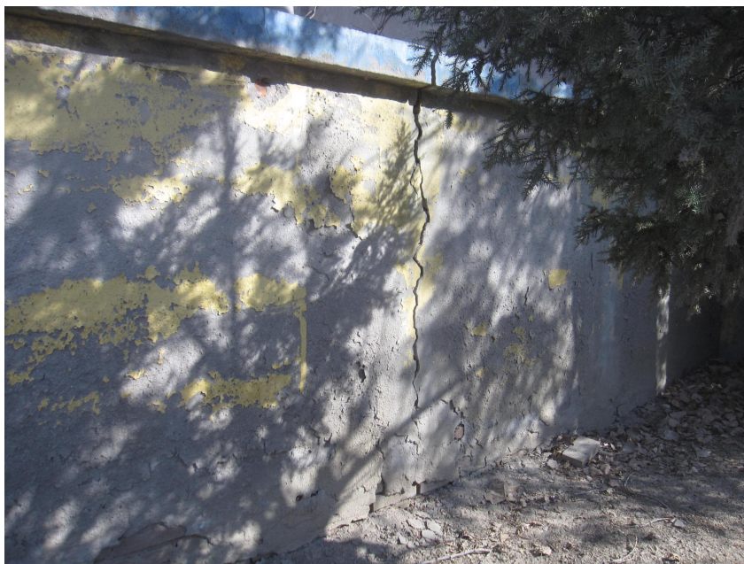
图 3-4 河津营村院墙开裂（镜像北）
