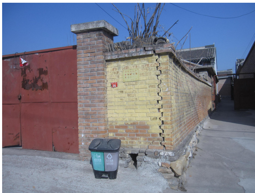
图 3-3 河津营村院墙开裂（镜像北）
